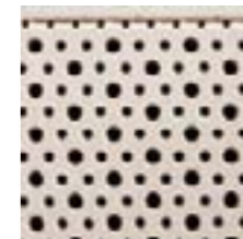
Fori aerazione perché impediscono la formazione di muffe
